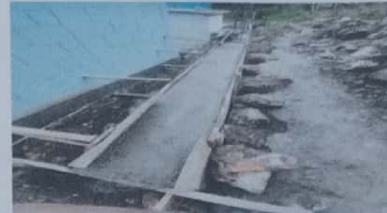
No. 2 MEJORAMIENTO DE MURO CERRAMIENTO PERIMETRAL E INSTALACIÓN DE CUNETA CON REJILLA CON MANEJO DE AGUA PLUVIAL
